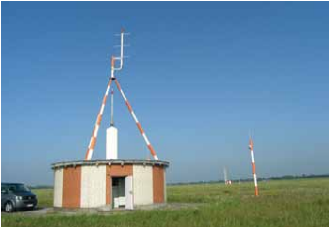
Eine GBAS-Anlage am Flughafen Bremen
